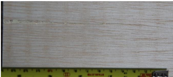
Gefüllte Risse bis zu 3 mm Breite
