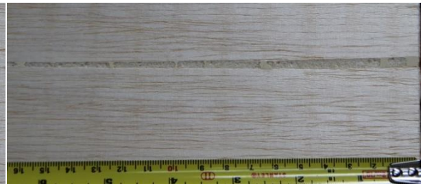
Gefüllte Risse bis zu 5 mm Breite
