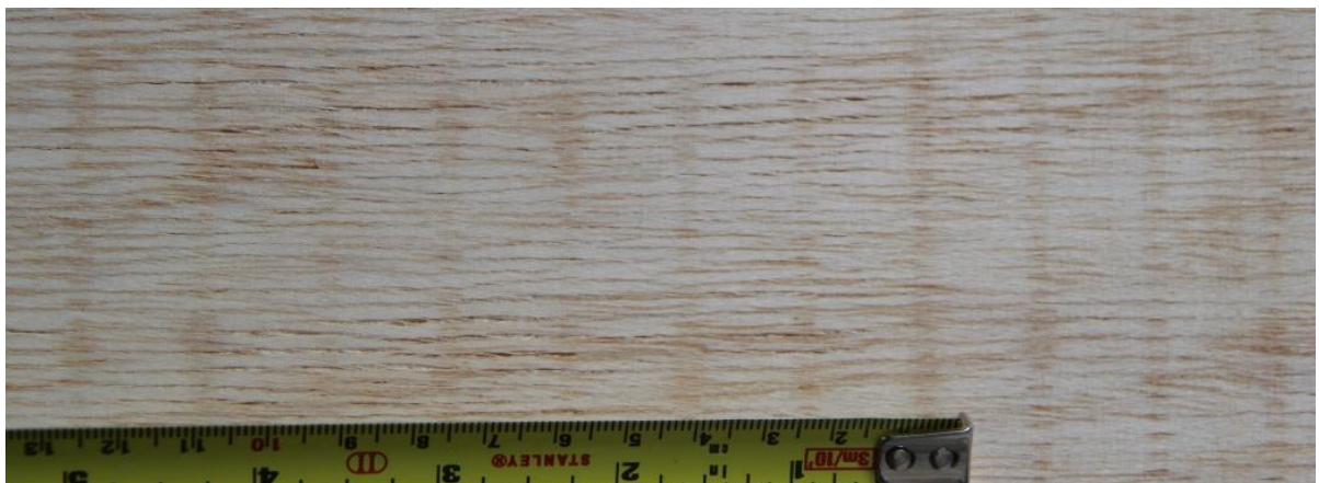
Feine durchlaufende Haarrisse an der Oberfläche bis 0.5mm Breite sind typisch
